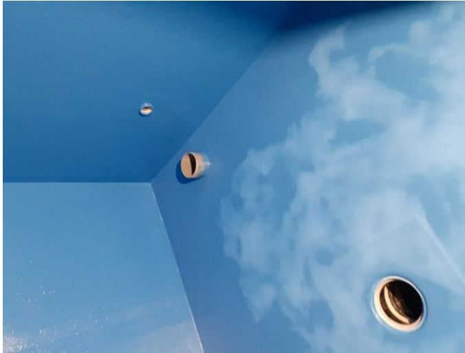
Vesieristetty pesuhuoneen lattia, märkä vesieristys näkyy vaaleampana. Kuva Ammattiopisto Lappia.
